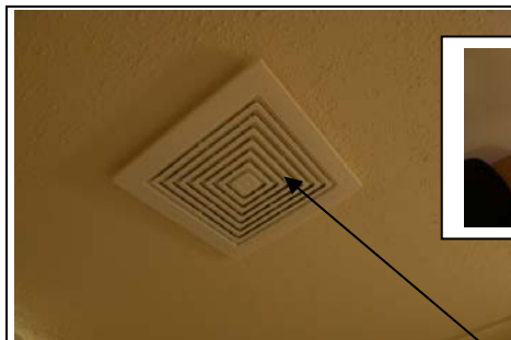
Basement Bath Fan DNR/Switch
